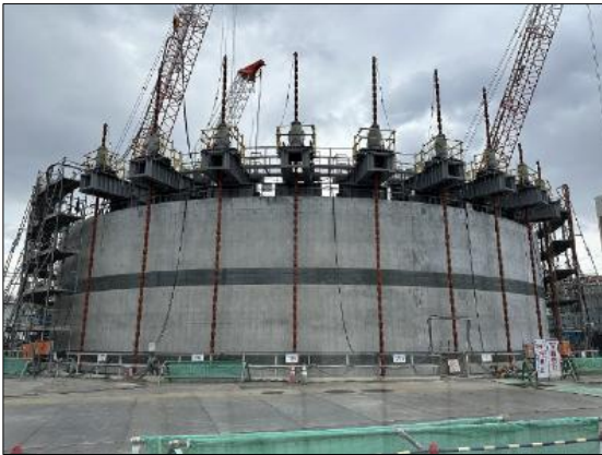
寝屋川北部地下河川（城北立坑）（※②）大阪市
