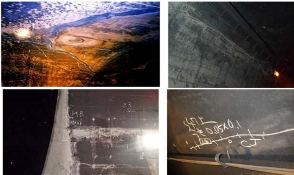
付写真-1.12 コールドジョイント付近に発生したひび割れの例
