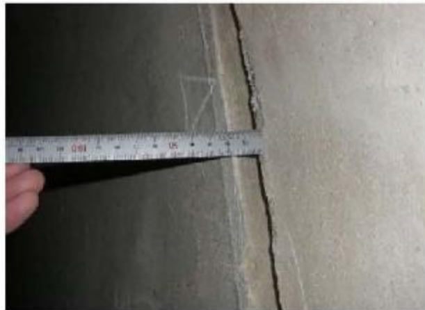
付図-1.10 目地部、打ち継目部の段差の例
