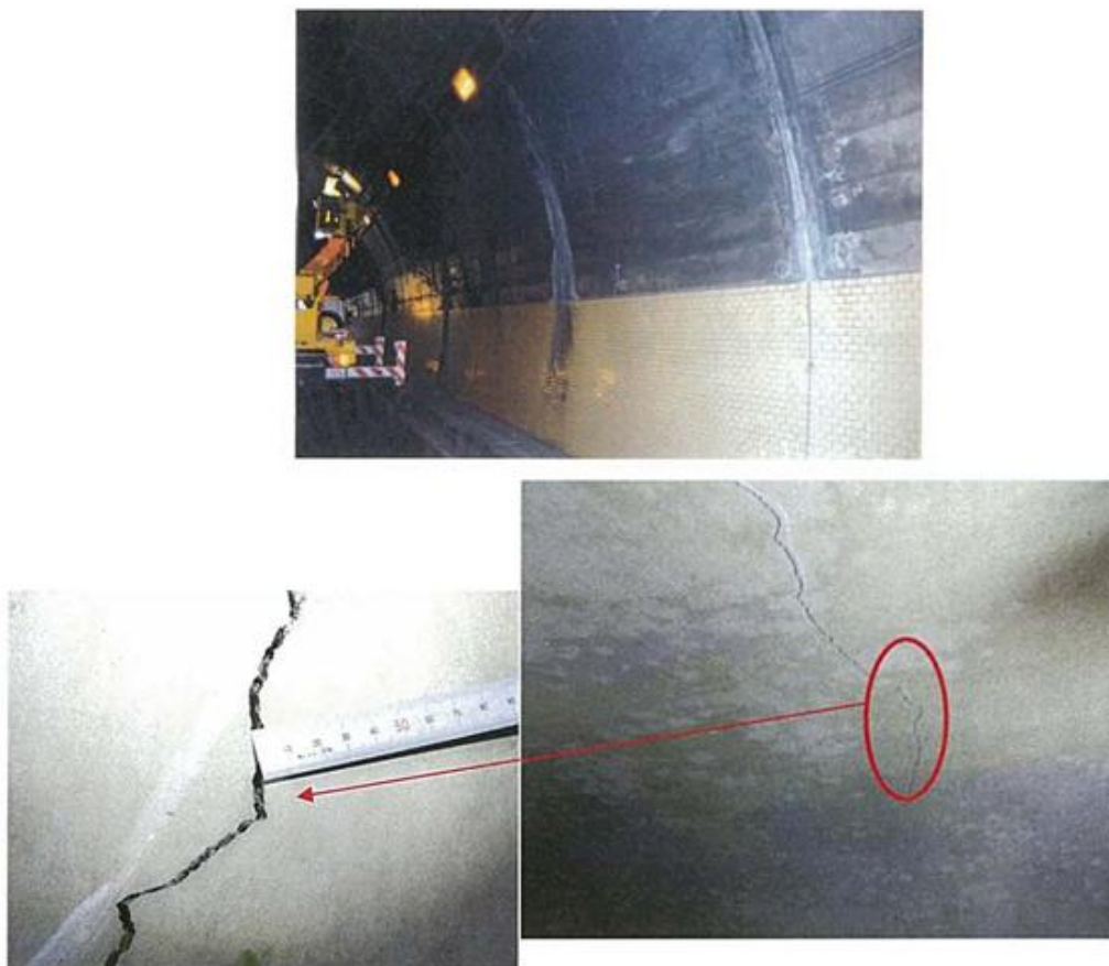
付写真-1.4 覆エスパンの中間付近に発生したひび割れの例
