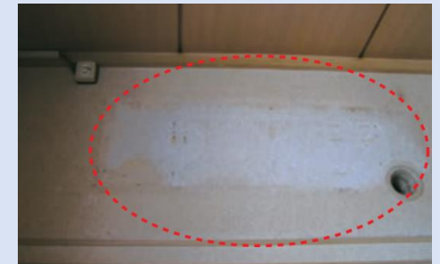
エアコン設置による壁のビス穴、跡
