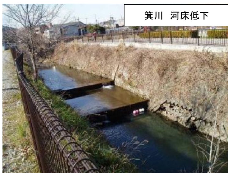
図-7 治水施設（護岸、水門等）の老朽化、河床低下
